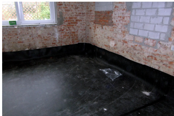
Im Haus der Familie G: ist die ABG-Abdichtung als innenliegende Wanne installiert.
